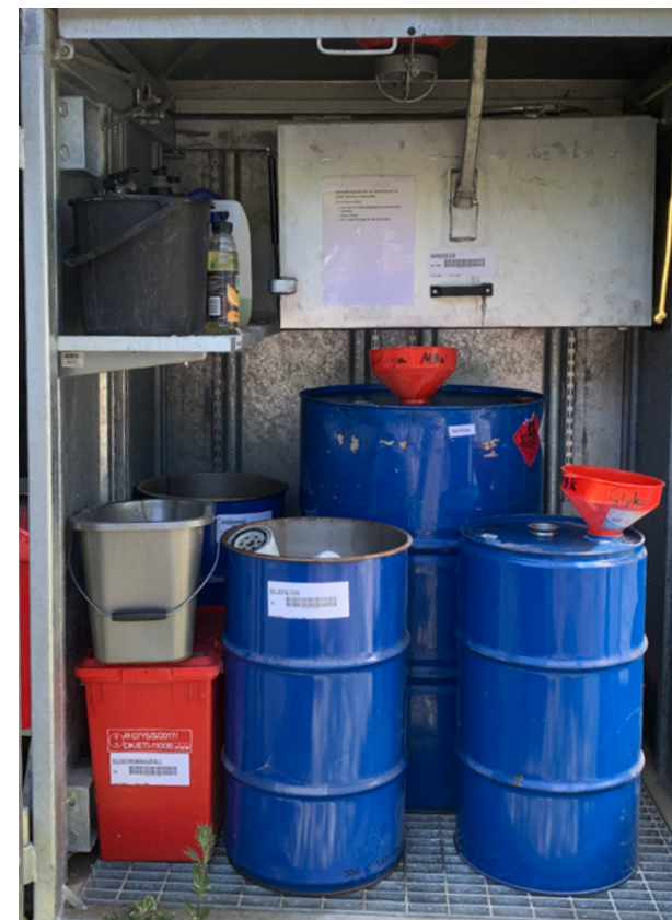
Miljöstation för farligt avfall.
