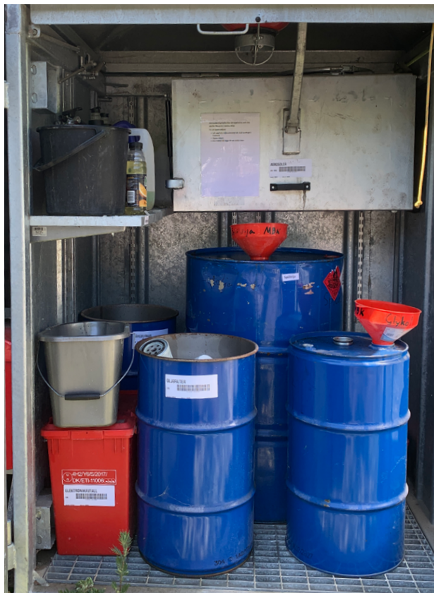
Miljöstation för farligt avfall.
