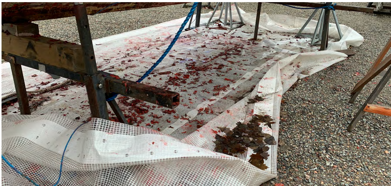
Bild 9:5 Vid skrapning/slipning av båtens botten är det viktigt att se till att inga skraprester/slipdamm kommer på marken eller till luften. Det är bra att täcka marken, men så här får det absolut inte se ut – minsta vindpust så hamnar damm och skraprester på marken. Foto: Jimmy Dominus.
