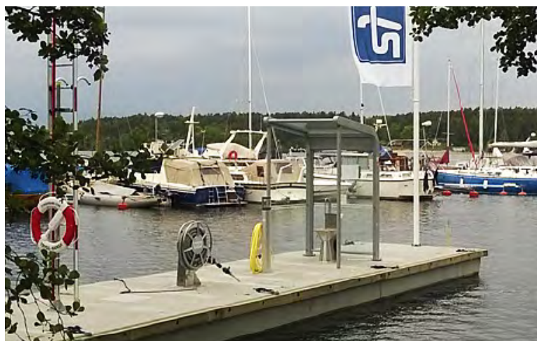
Bild 5:4 Exempel på tömningsstation på ponton och ansluten till kommunalt avlopp. Utslagsträtt för portabel toalett finns också. Foto: Jimmy Dominius.
